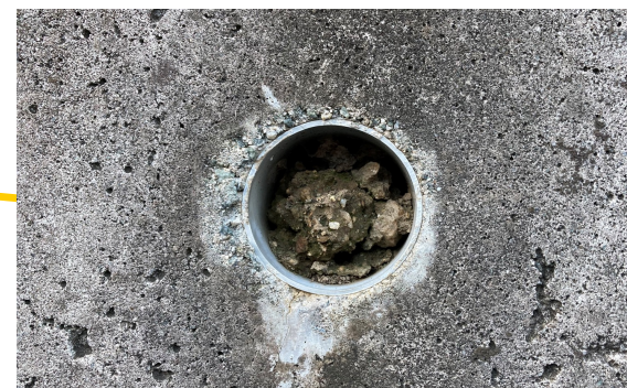
土砂が堆積した水抜き孔
